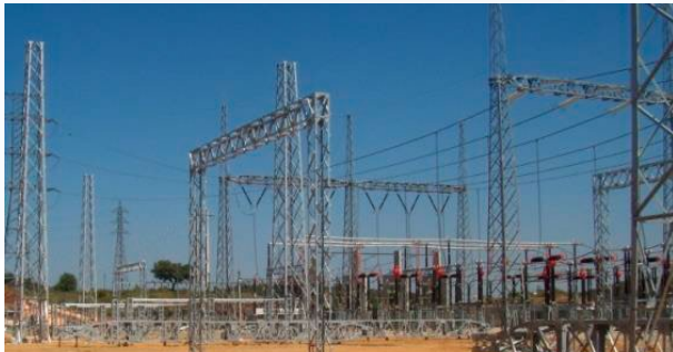
Subestación da REN, Alqueva
