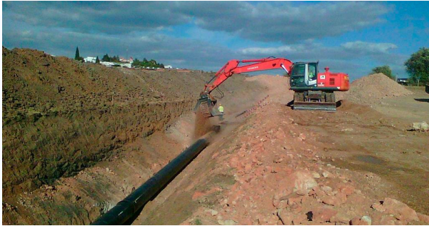
Circuito hidráulico de Vale do Gaio, Torrão
